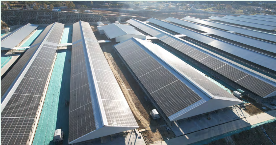
奶牛厂房上的屋顶光伏设施
