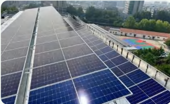
屋面光伏组件
