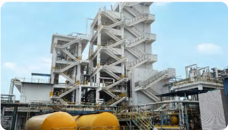
三氟甲烷 (HFC-23) 资源化转化示范装置
