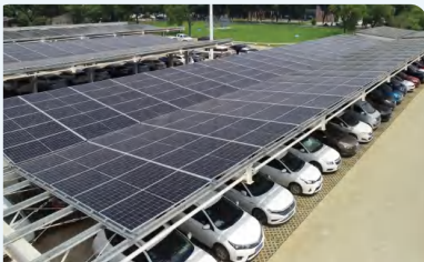
“光储充零碳单元”充电站
