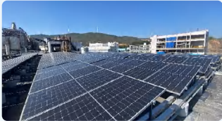
郴州基地分布式光伏发电项目
