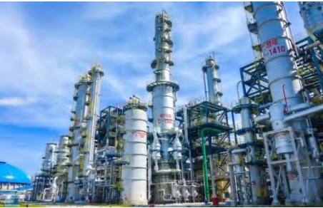
泉州石化精馏系统
