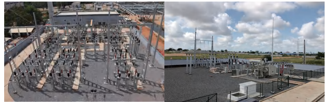
项目变电站及电力中控枢纽
